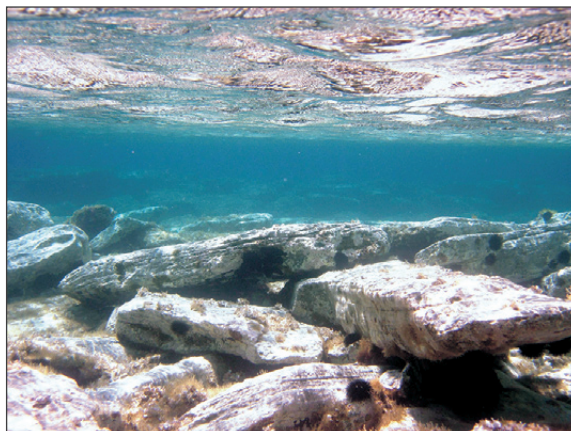
Εικ. 4. Παλαιόπολη Άνδρου. Άποψη του υλικού αποσύνθεσης του κρηπιδώματος του προσήνεμου λιμενοβραχίονα, στο εσωτερικό της λιμενολεκάνης (©ΕΕΑ – Λήψη Θ. Θεοδούλου).
